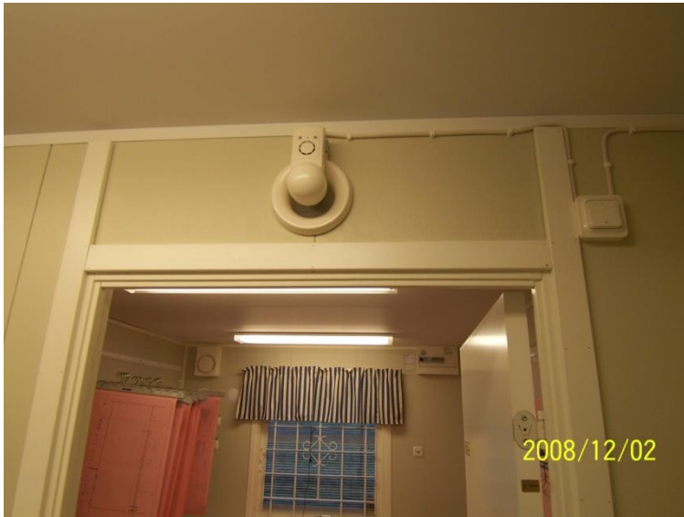
Bild 6. Värmeförflyttare (PAX-fläkt) mellan korridor och kontorsrum.
